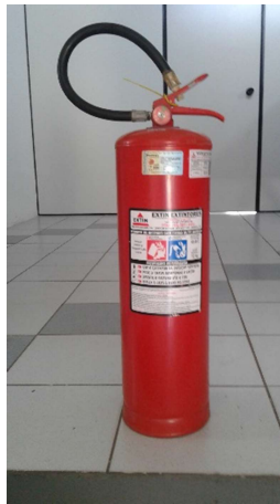
Figura 10: extintor PQS 12 kg. Fonte: autores (2019).
