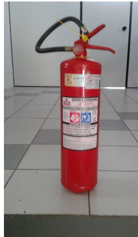
Figura 8: extintor PQS 06 kg. Fonte: autores (2019).
